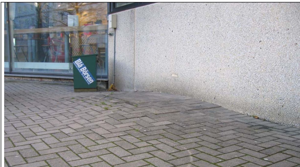
Figur 4.3 Exempel på differenssättningar vid södra fasaden på låghusdelen.
